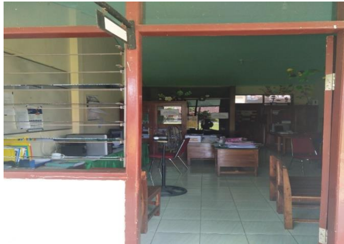
Gambar 4.11 Kondisi Ruang BK yang Belum Layak 46
