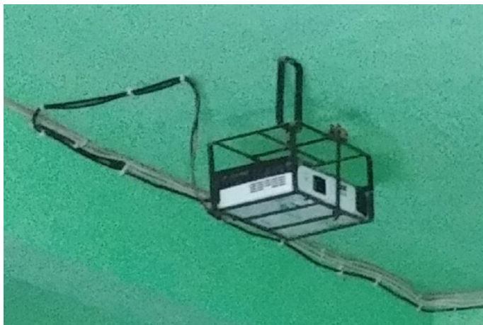
Gambar 4.15 Fasilitas proyektor sekolah yang rusak
