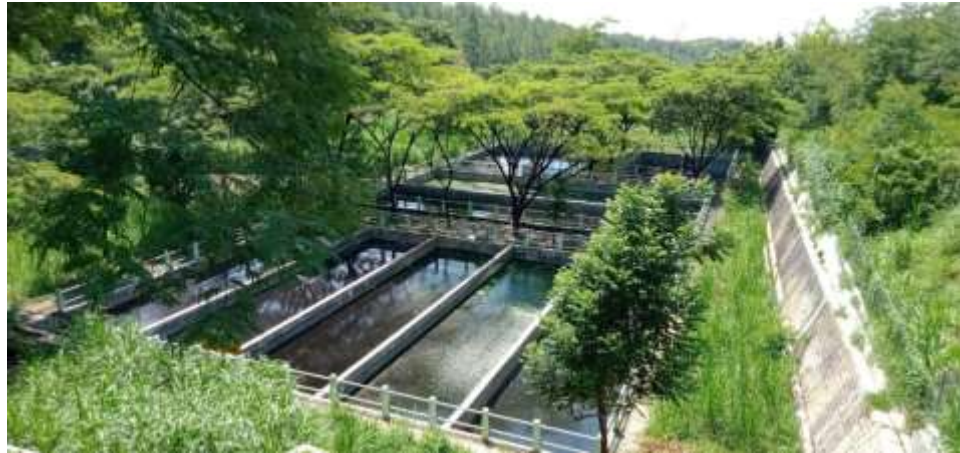
Gambar 4.1.3 Kolam IPAL TPA Segawe
