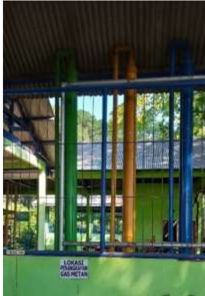
Gambar 4.1.4 Pipa Penangkap Gas Metana
