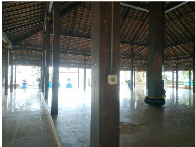
Gambar 1.6 Stop Kontak untuk Fasilitas Pengunjung
