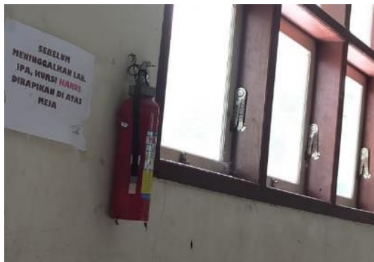
Gambar 4.3 Alat Pemadam Kebakaran
