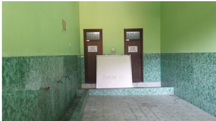
Gambar 4. 20 Fasilitas kamar mandi yang rusak
