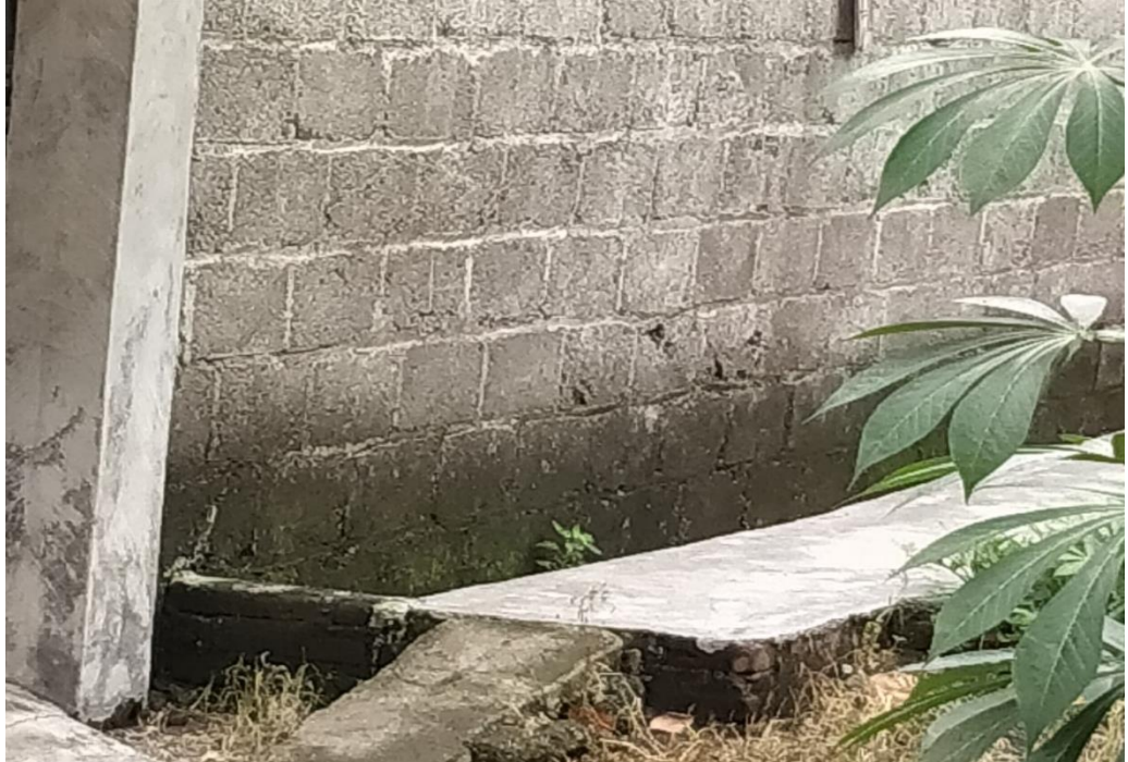
Gambar 7 Salah satu fasilitas saluran air kotor pada kandang
